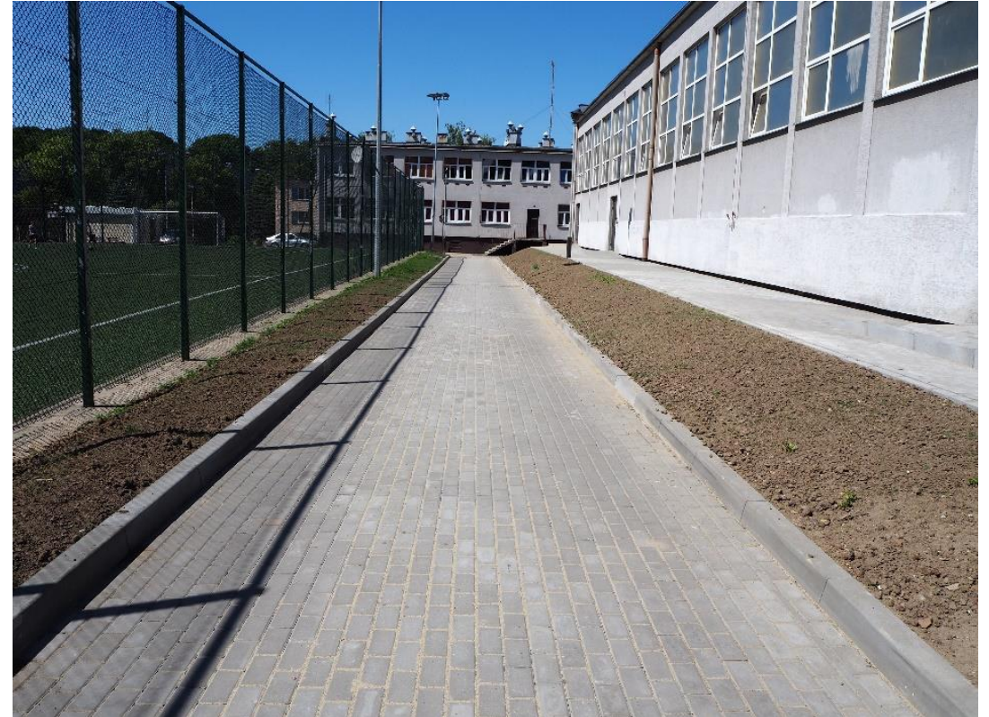
Utwardzenie terenu działek Szkoły Podstawowej nr 11 wraz z budową wjazdu od ul. Kraszewskiego
